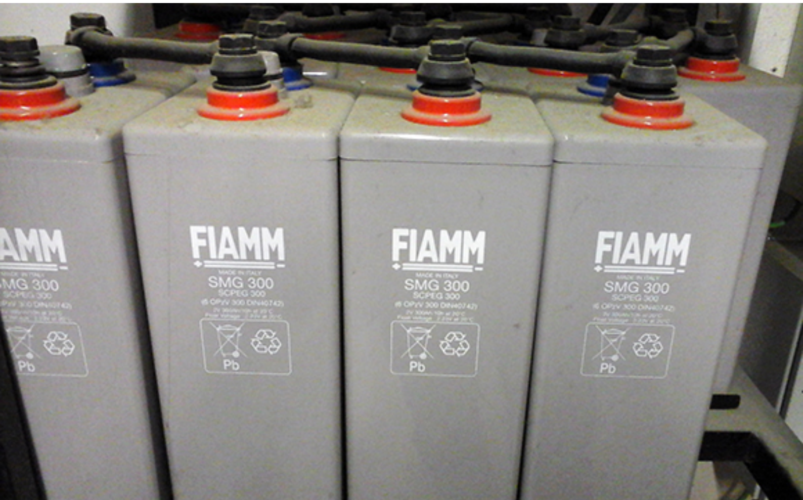
Unités de stockage chimique de l'électricité.
