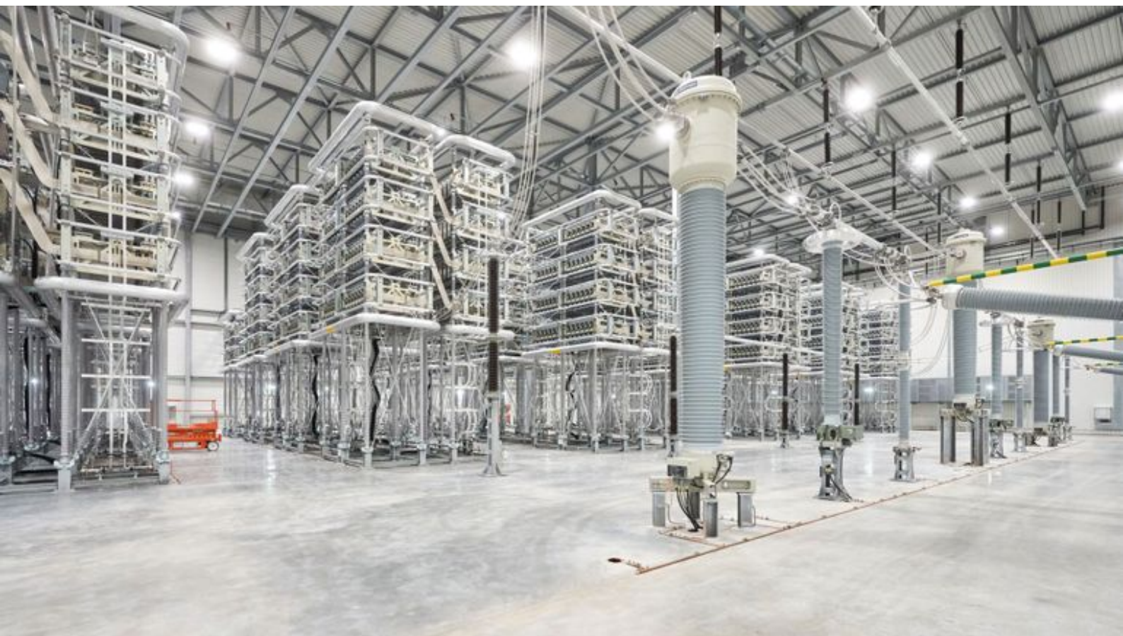
La station de conversion de Lixhe, une infrastructure inédite en Wallonie. Photo: Elia.
